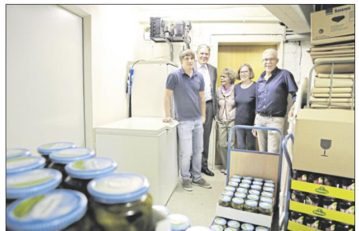
Die alten Kühlgeräte sowie der Generator für den Kühlraum im Erdgeschoss verbrauchen auch viel Strom.
